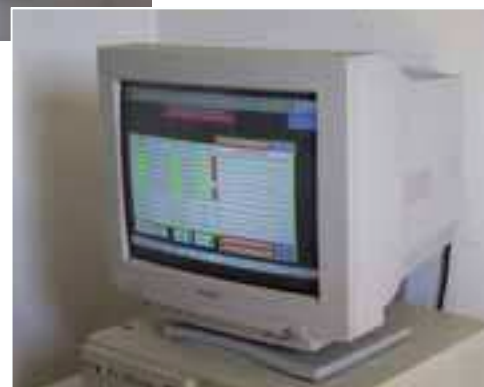
La postazione di controllo
