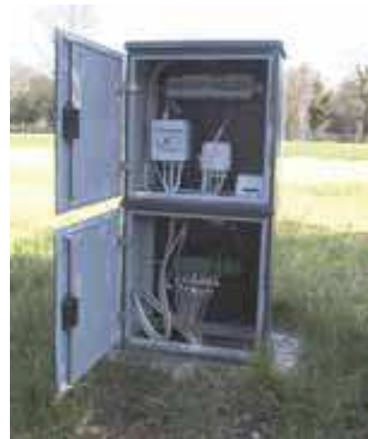
Il comando delle pompe
